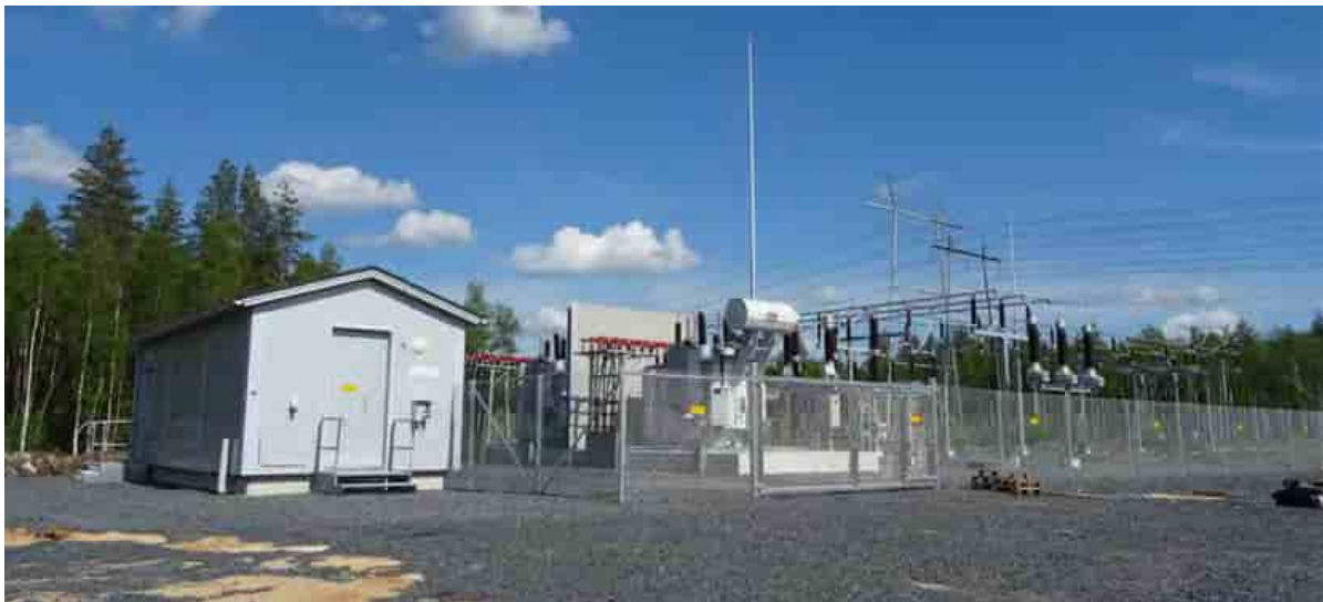
Kuva 45. Esimerkki tuulivoimapuiston sähköasemasta (Oltava, Pyhäjoki).
